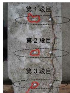
図-10 新設梁と既存梁の切断面のひび割れ
