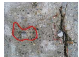
図-11 第1段目ひび割れ拡大図
