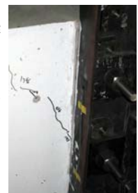
図-21 壁と梁のずれ (JPS 試験体)
