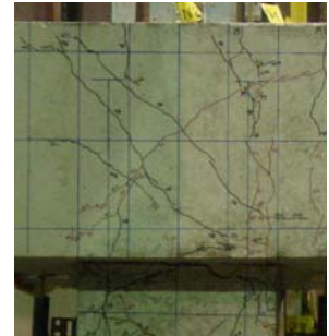
写真-1 FL-1 破壊状況 (R=±1/25)
