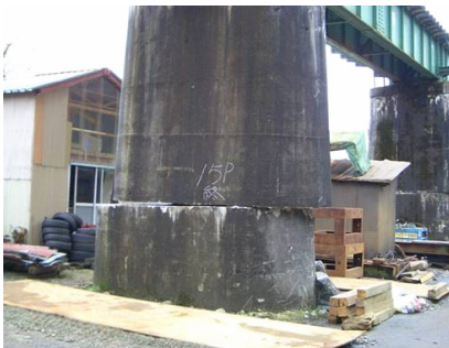
写真-1 新潟県中越地震による被災状況
