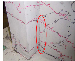
写真-2 ひび割れ状況 (No.2 試験体)
