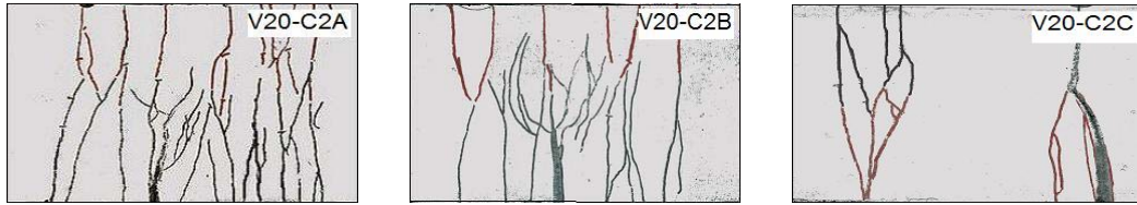
図-5 最終ひび割れ状況
