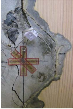
写真-2 破壊性状 (Aa-1-h90t30 右側シアキー底部せん断破壊)
