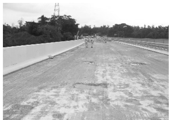
写真-2 床版上面劣化状況
