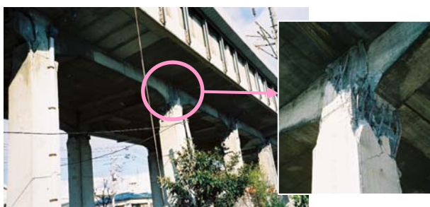
図-5.2 部材接合部の損傷
