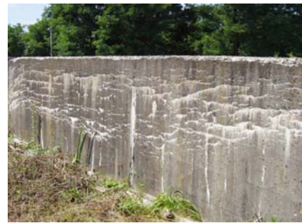
(a) 長手方向ひび割れ（側壁の背面側）
