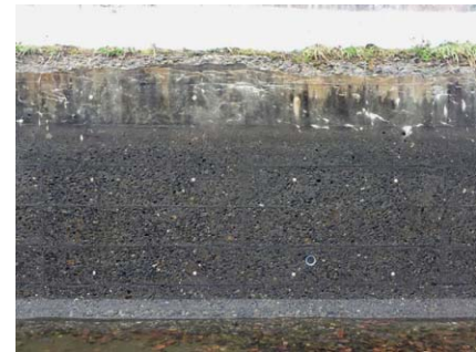
(b) 最多頻度水位の上部のひび割れ
