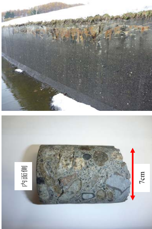
写真－6 別の開水路における凍害の発生状況
