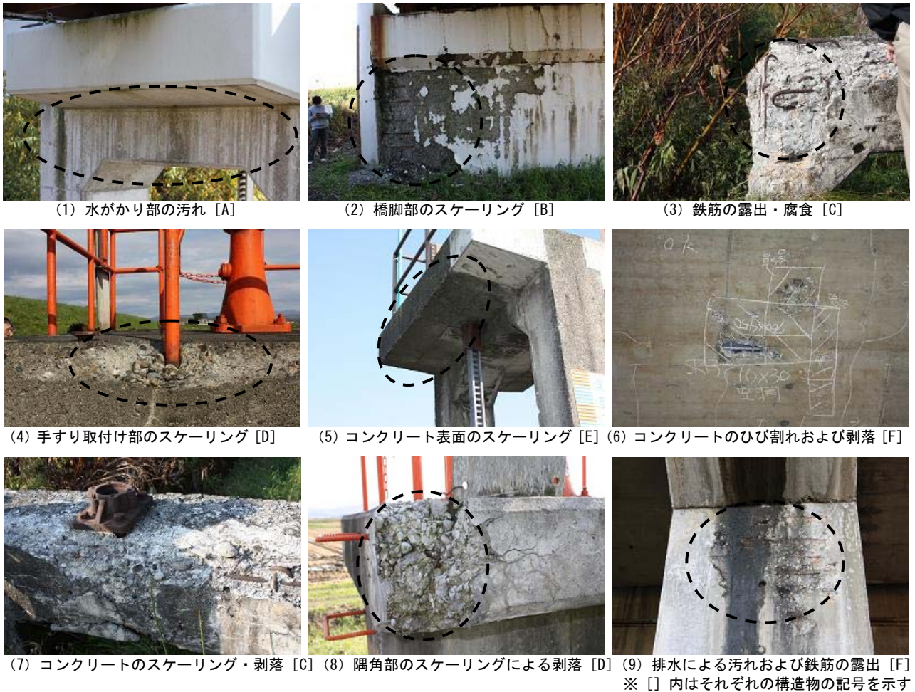
写真-1 各構造物の劣化状況
