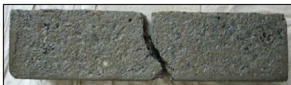
(b) 割裂状況 (側面) (B_crack : 198 サイクル)
