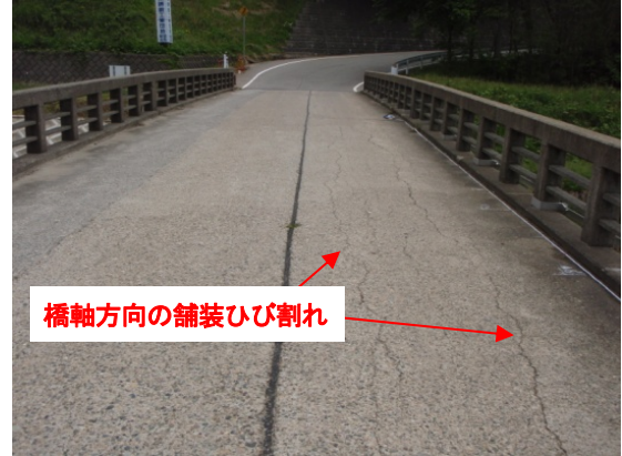
写真-1 コンクリート舗装のひび割れ状況(事例 4)
