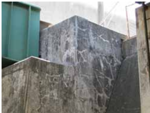
写真 - 1 ASR によるひび割れが発生した橋台
