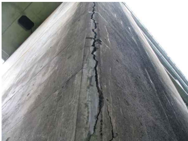
写真-3 橋脚・柱の隅角部の割れ (P橋)
