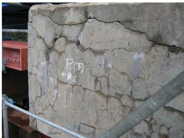
写真-2 橋脚・はり先端の割れ (D 橋)
