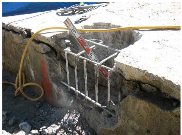
写真-4 橋脚・フーチングの隅角部の割れ (J橋)
