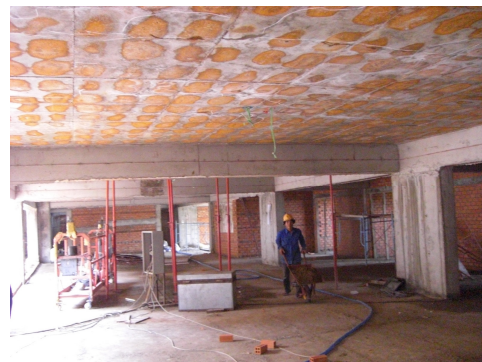
写真-1 倉庫がない為型枠錆びによる天井錆び
