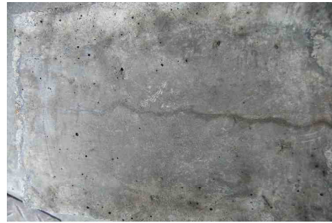
図 - 13 電食により発生させたひび割れの様子
