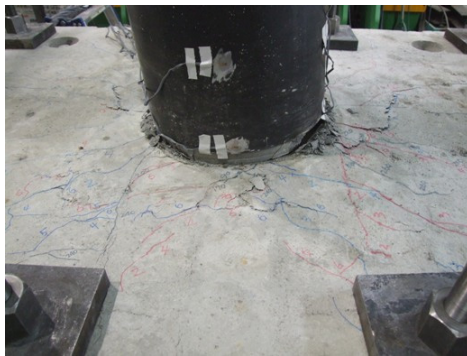
写真二 K6 試験体最大荷重付近の状況
