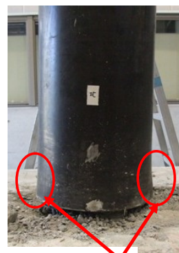
鋼管下端変形
