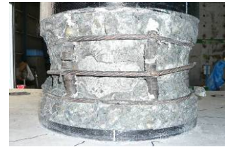
写真-3 軸方向鉄筋の破断
