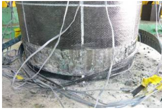
写真-1 CFS 破断
