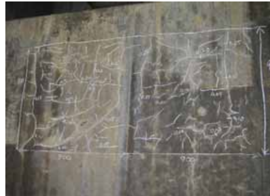
写真-1 世渡橋A1 橋台正面中央のひびわれ状況写真 1)
