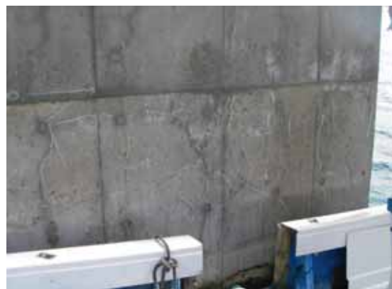
写真-2 B 橋P24 橋脚西側面ひびわれ状況写真 1)
