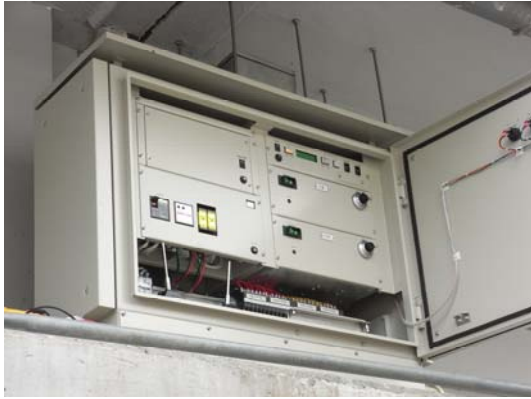
写真-3 遠隔監視システム内蔵直流電源装置
