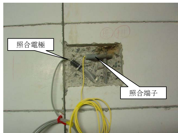
写真-2 照合電極の設置位置 (一例)
