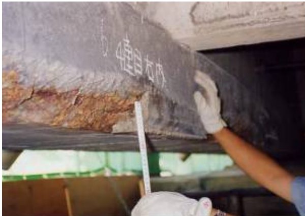
図-2 塩害劣化損傷状況
