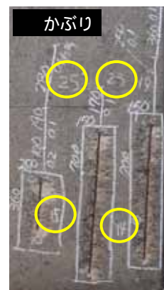
写真-3 ひび割れと剥離剥落 (A及びB高架橋)
