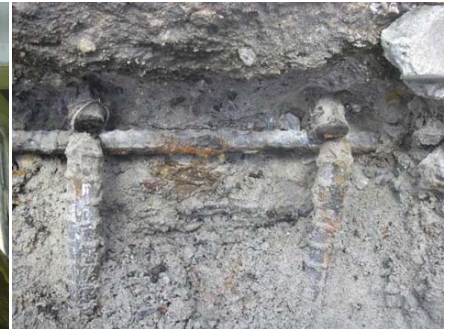
(3) PC 梁部 (B 橋) の鉄筋破断状況
