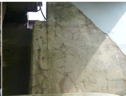
(5) 橋脚 (C 橋) のひび割れ状況
