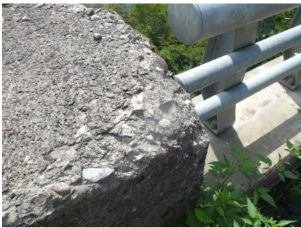
(1) 高欄 (A 橋) のスケーリング
