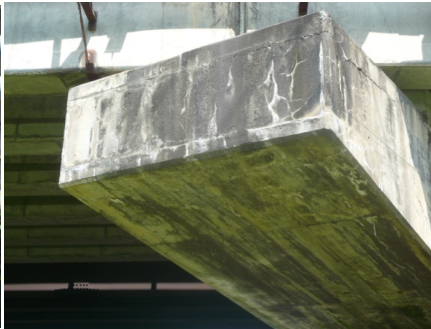
(2) PC 梁部 (B 橋) のひび割れ状況
