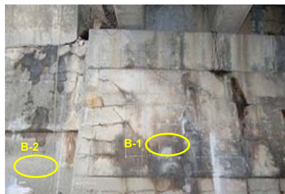
写真-2 事例 B の劣化状況およびコア採取位置
