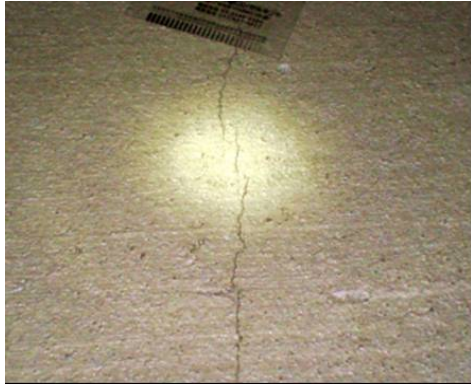
写真-6 配合2の施工後に生じた縦ひび割れ
