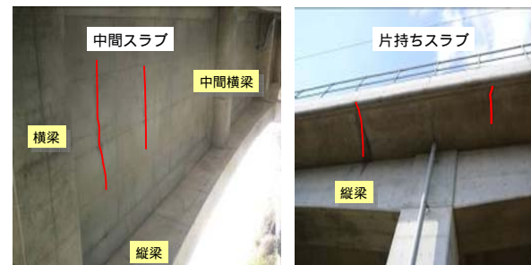
図-1 高架橋スラブのひび割れ例
