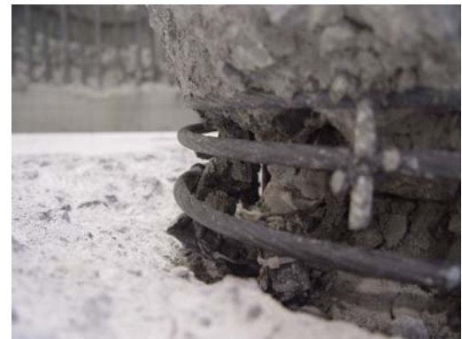
写真6 No.2 軸方向鉄筋破断状況 (試験終了後)
