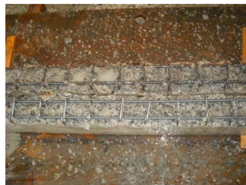
写真-1 はつり作業後の供試体
