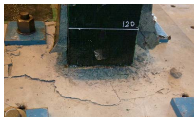
写真-4 供試体 No. 4 における 実験終了時の引張側柱基部の状況
