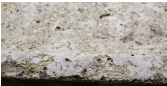
写真－3 千歳7-ローモン(c)60凹の劣化
