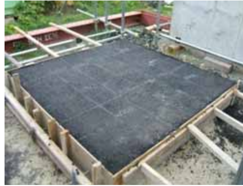
写真-8 アスファルト舗装を有する試験体(H2)
