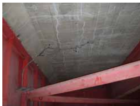
写真 - 6 床版下面状況
