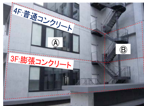
写真-1 ひび割れの評価箇所
