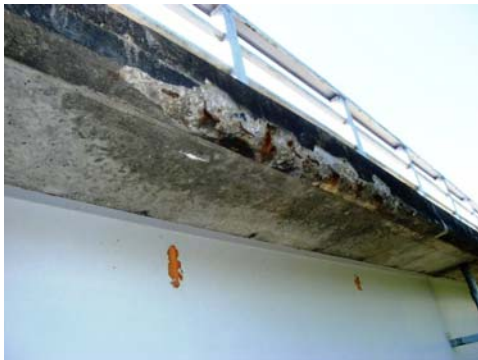
写真-1 変形・欠損の状況 (I橋)
