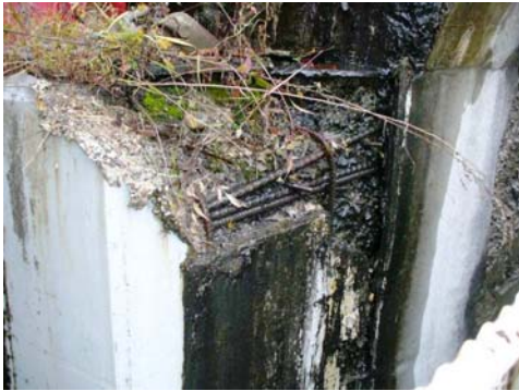
写真-2 剥離・鉄筋露出の状況 (E橋)
