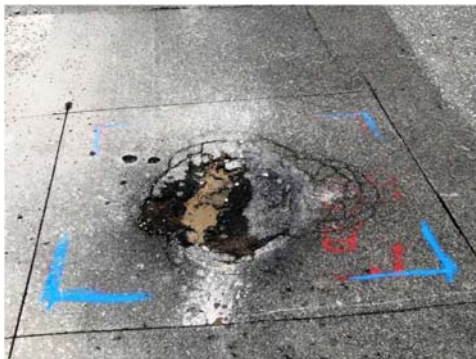
写真-3 舗装面に生じたポットホール（E橋）
