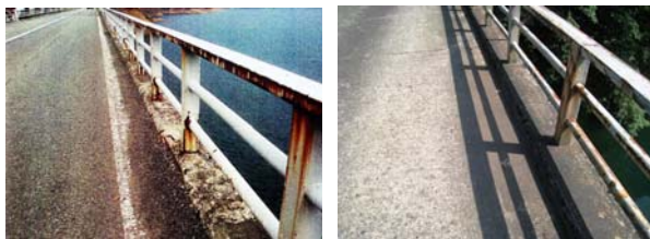
写真-5 凍害によるスケーリングの劣化程度の違い (左：凍結防止剤散布橋梁 右：非散布橋梁)
