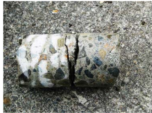
写真-4 採取したコアの水平ひび割れの状況
