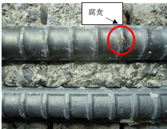
写真-1 F15(2)の鉄筋腐食状況
