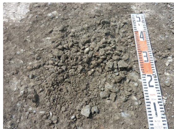
写真-1 劣化床版上縁の砂利化
