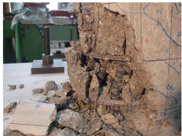
図-6 No.2 1/10 荷重後の状況
