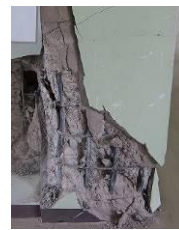
写真-1 柱脚圧壊
