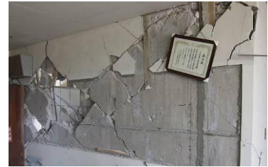
写真-2 耐震壁のコンクリート剥落
