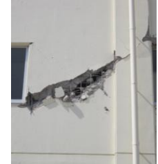
写真-5 袖壁付柱の 損傷状態
