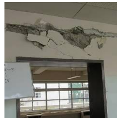
写真-3 開口付耐震壁のスリット プによる水平ひび割れ
