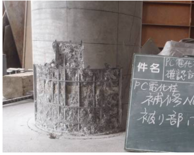
写真-3 補修前 (試験体 No. 2)
