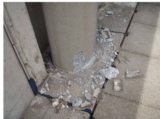
(a) 損傷タイプ 1
