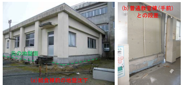
写真 2-4 給食棟前の地盤沈下と普通教室棟との段差
