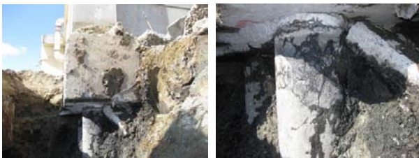
写真3-5 給食棟無沈下基礎D18杭頭部のひび割れ
