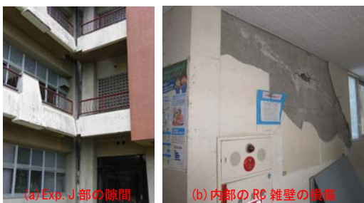
写真 2-3 普通教室棟の傾斜による被害と壁の損傷
