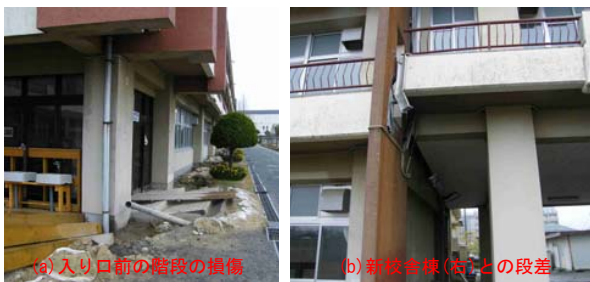
写真 2-2 普通教室棟の沈下による各部の被害
