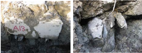
写真3-3 A13フーチングの破壊と杭頭破損
