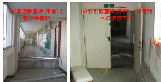
写真 2-5 校舎内の段差
