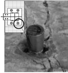
写真-1 アンカーボルト近傍の破壊状況
