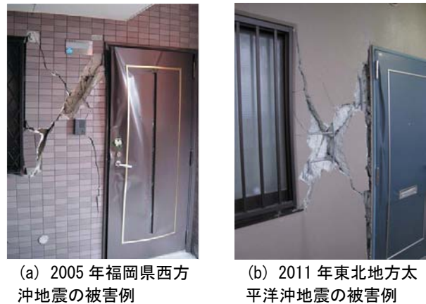
図-1 二次壁の地震被害例
