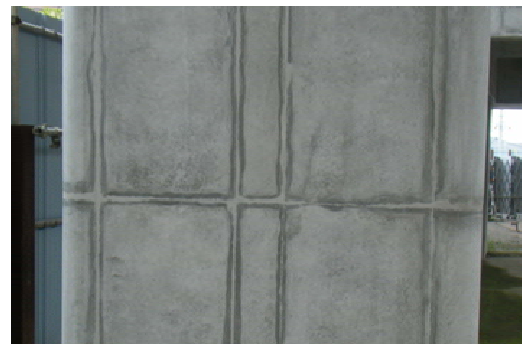
(2) 型枠の継目に生じた砂すじ
