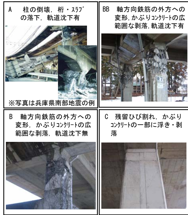
図-2 損傷度の分類
