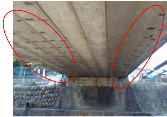
図-14 かぶり不足による鉄筋の早期腐食
