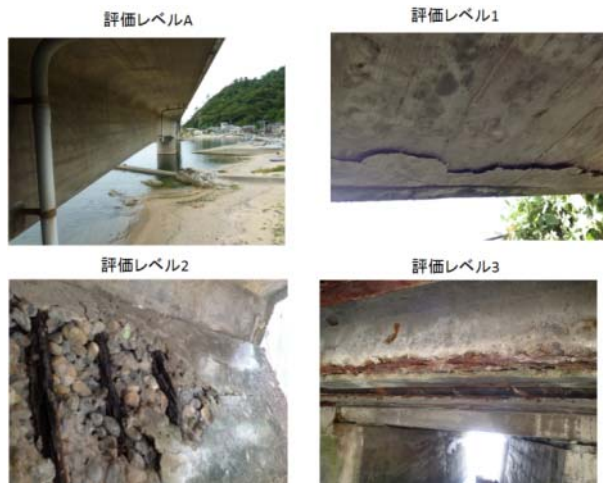
図-2 各評価レベルの劣化状況の例
