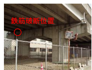
写真-2 A橋の建設後12年の状況
