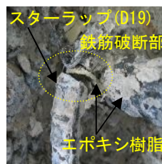
写真-1 鉄筋破断面の樹脂跡
