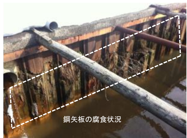
写真-1 鋼矢板腐食が極度に進行した水路施設概観
