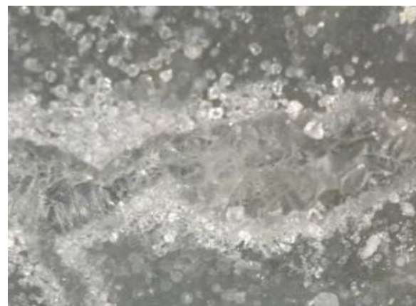
図-6 PVAIII シリーズのひび割れ拡大画像
