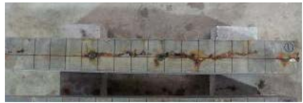
写真-1 ひび割れの全景
