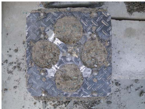
写真 -2 試験体 No. 1 の補強鋼板の破断
